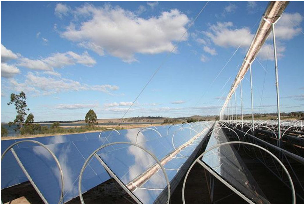
Εικόνα 3.3. Σύστημα Linear Fresnel Reflector
