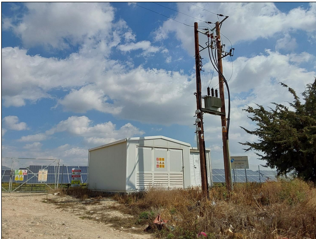
Εικόνα 6.9. Δίκτυο μέσης τάσης και γειτονικό φωτοβολταϊκό πάρκο στο βόρειο τμήμα του τεμαχίου (Aeoliki Ltd, 2023)
