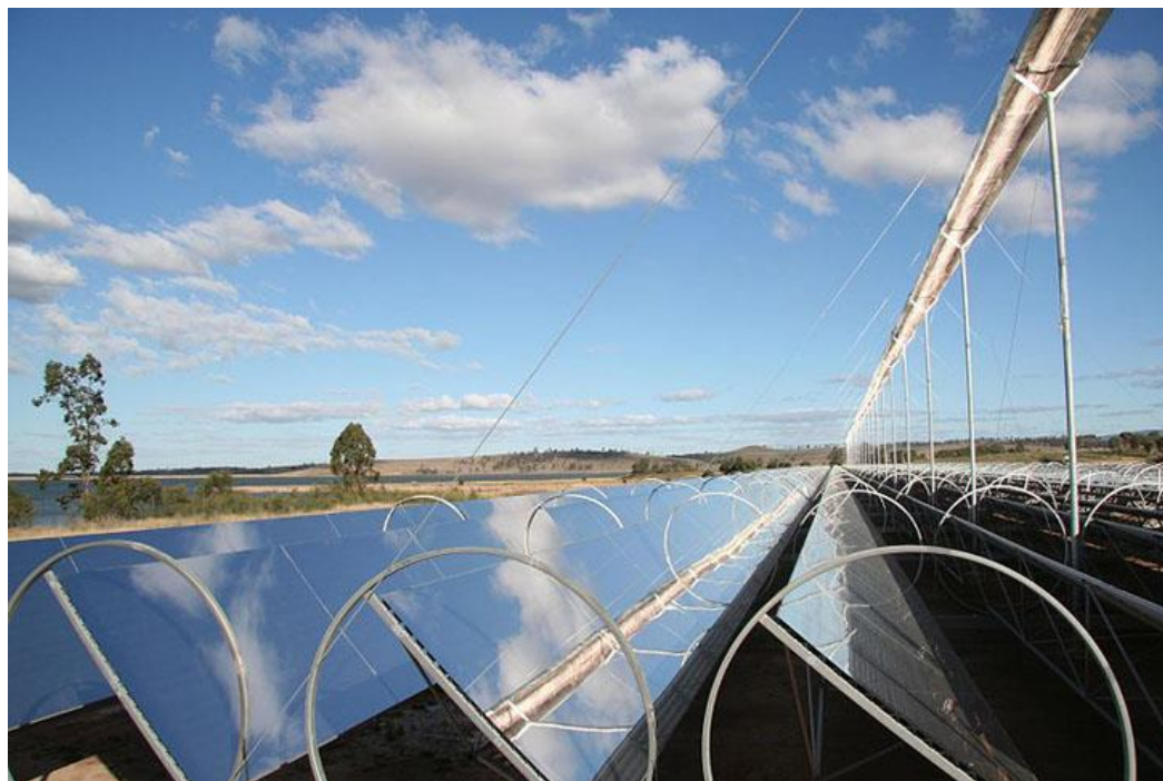
Εικόνα 3.3. Σύστημα Linear Fresnel Reflector
