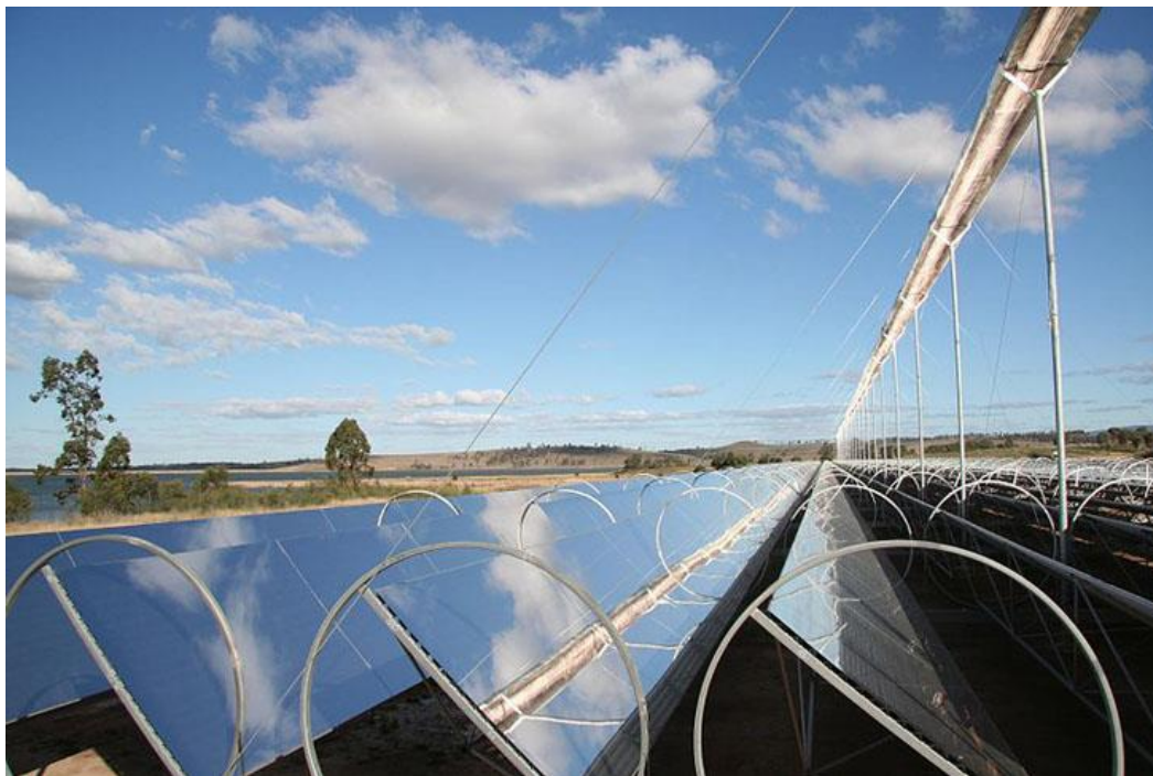
Εικόνα 3-3. Σύστημα Linear Fresnel Reflector
